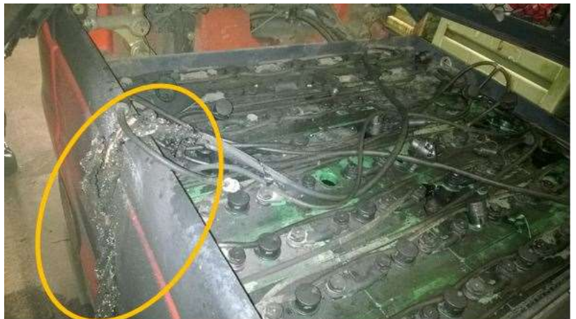
Batteriebrand eines Gabelstaplers aufgrund beschädigter Ladekabel.
