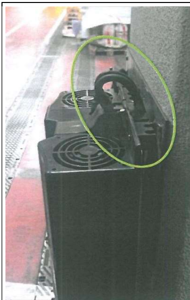
Batterieladegerät, welches an der Wand montiert ist und bei welchem die Kabel ordnungsgemäß durch die Zugentlastung hinter dem Gerät befestigt wurden.
